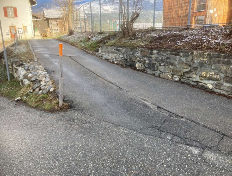
Zufahrtsstr. MZH mit beschädigter talseitiger Stützmauer und abgesenktem Strassenprofil
