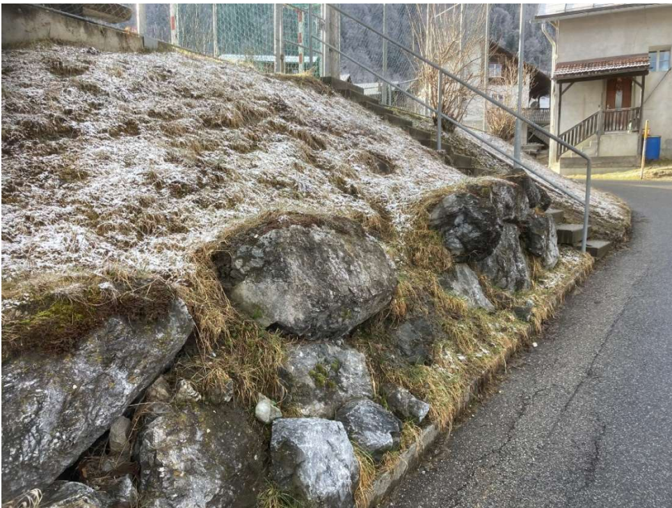
Zufahrtsstr. MZH mit beschädigter bergseitiger Stützmauer
