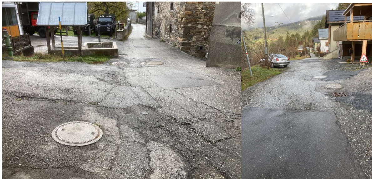
Löchriger Asphaltbelag der sich in Einzelteile auflöst
