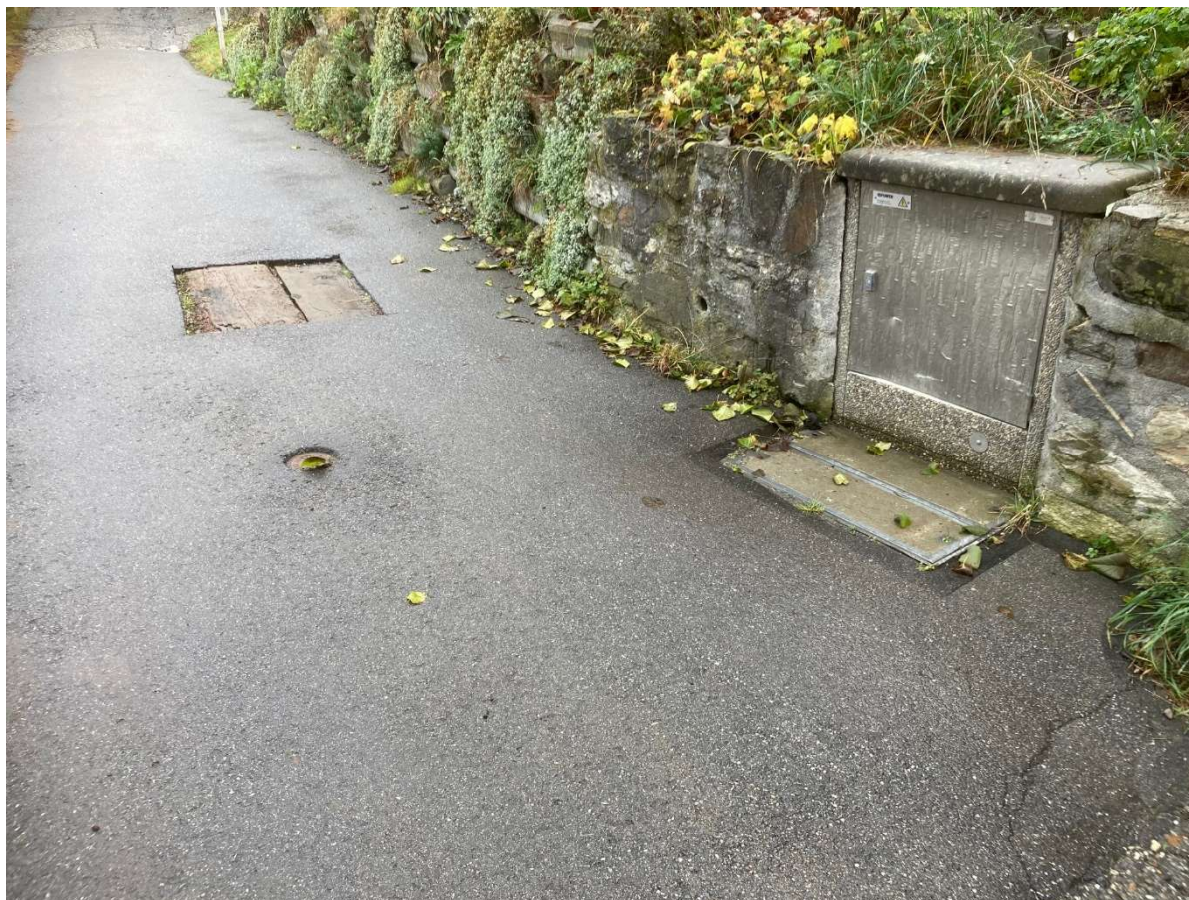
Strom-Kabelschacht mit Holzdeckel
