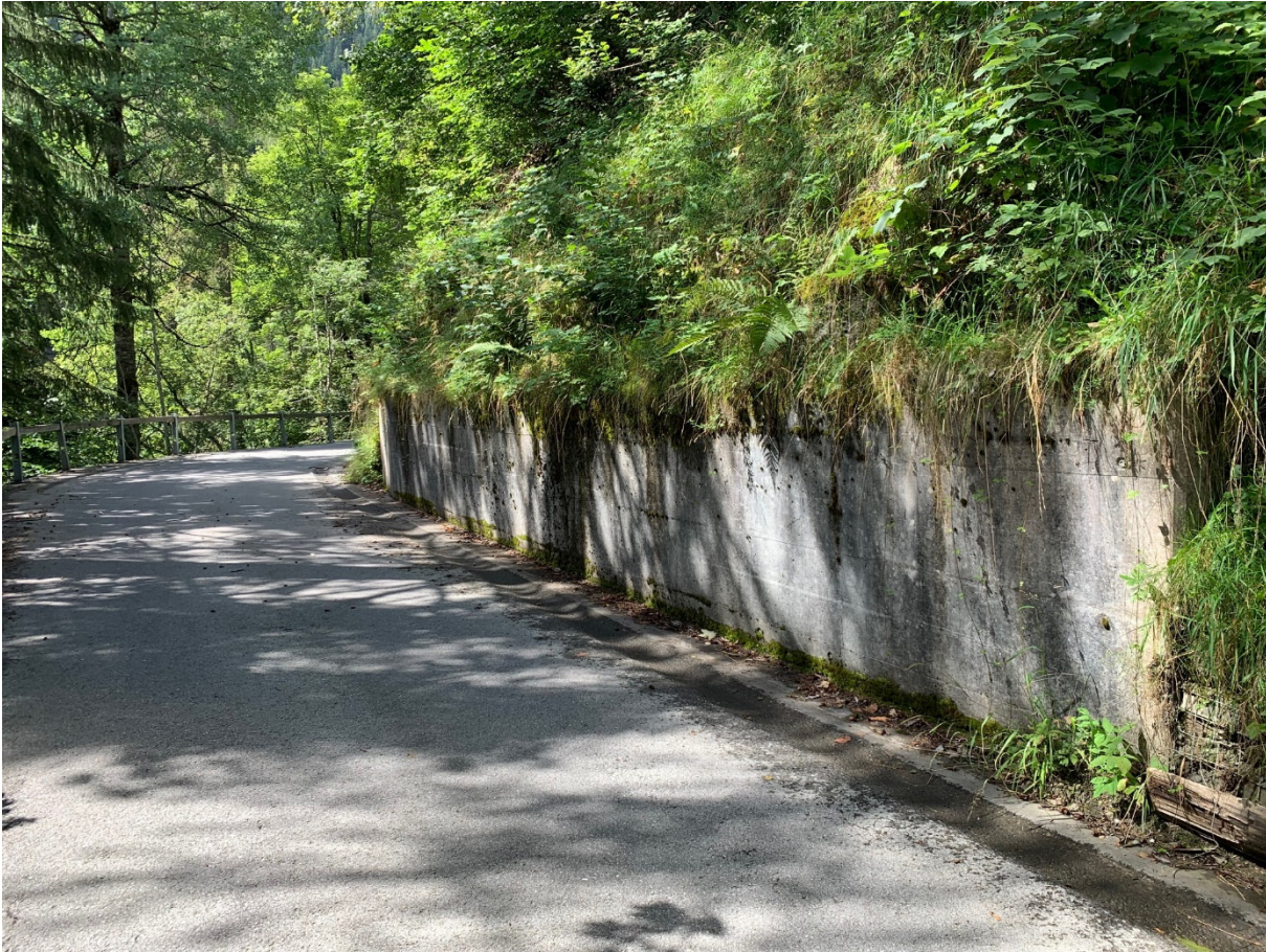
Instabile (schräge) bergseitige Stützmauer im Turischertobel
