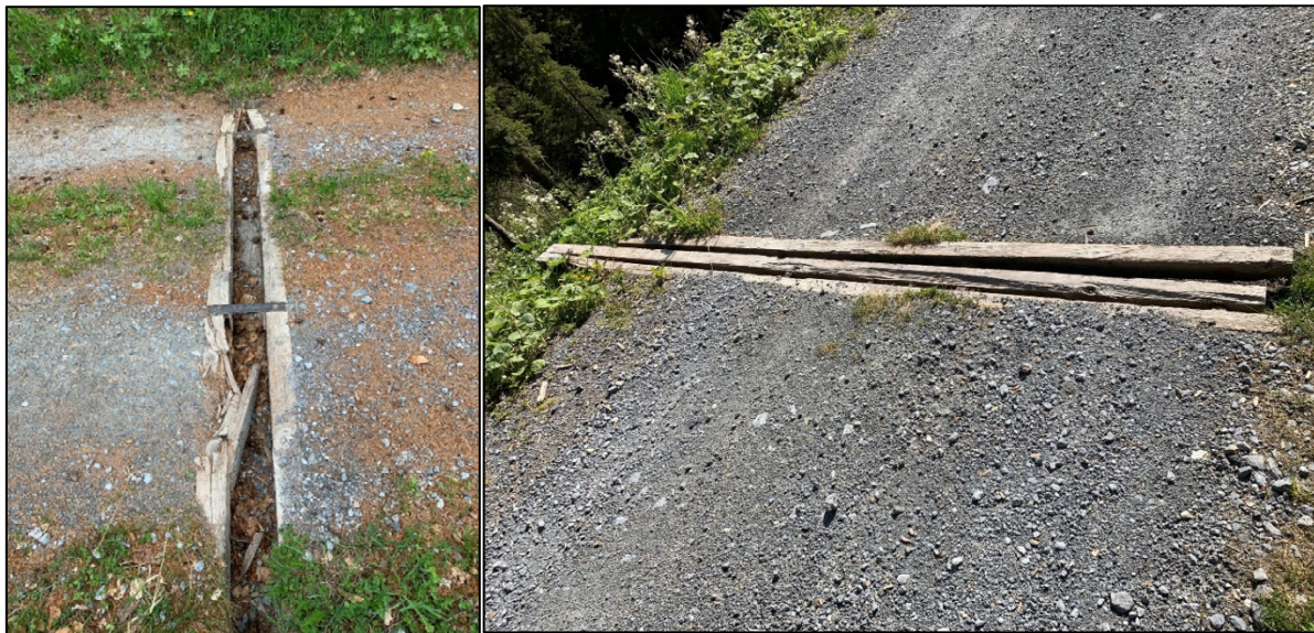
Morsche Querabschläge (Fahrbahntwässerung)
