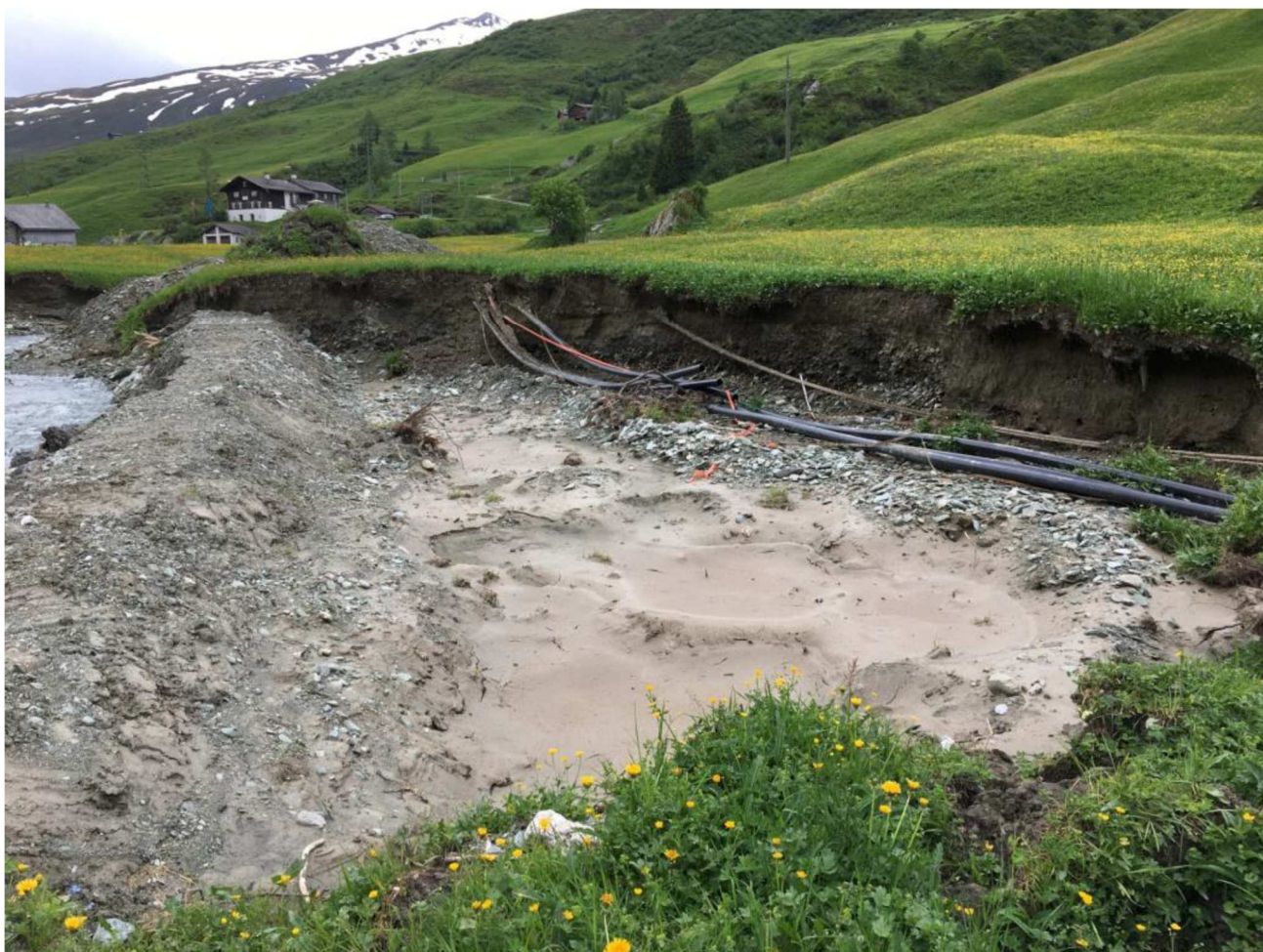
Thalkirch (Turraboda): Durch das Hochwasser freigelegte Glasfaserkabel der Swisscom
