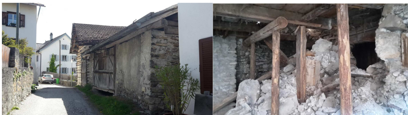
Im Anbau (rechts) des Türralistalles Ereignete sich der Schadenfall
