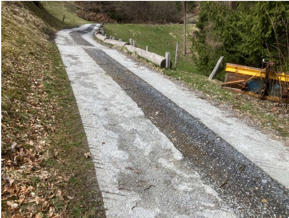
Güterstrasse Summergada – Aggelti: Talseitig markant abgesenkter Betonspurweg. Betonspuren sind durch den Salzeinsatz im Winterdienst stark beschädigt
