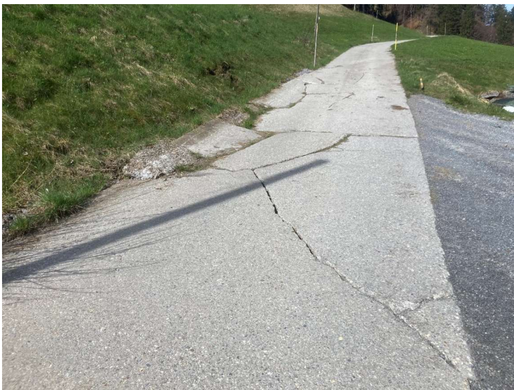
Güterstrasse Gadastatt – Oberguot: Stark eformierter/beschädigter Betonbelag
