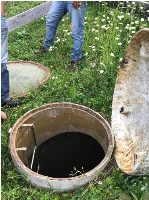
Einstieg in den Pumpschacht / Samelschacht, kaum erhöht, beschädigtes Insektengitter, nicht dicht
