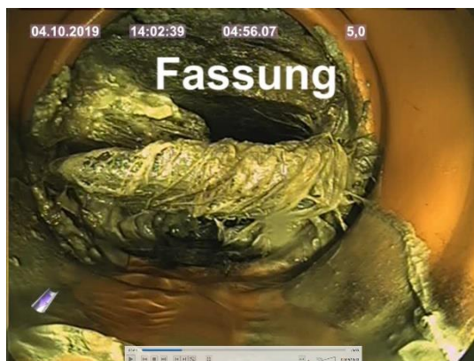
Eindruck Fassungsleitung / Fassungs- bereich
